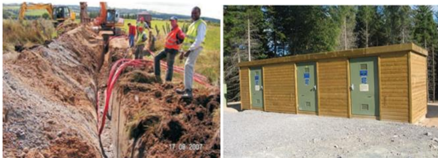
Photographie 6 : Déroutage et pose des câbles (à gauche), exemple de poste de livraison (à droite)
