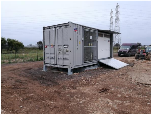
Figure 16 Exemple d'un poste de conversion
