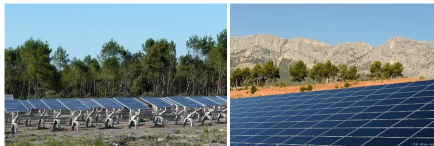
Photographie 1 : Structures solaires (à gauche : les trackers de la centrale de Gabardan (40) qui suivent le soleil ; à droite : structures fixes à Puylobier (13)) - Source : EDF Renouvelables
